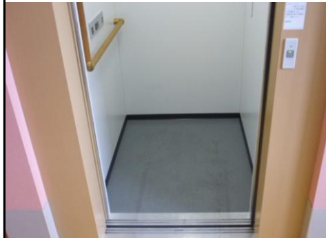
エレベーター
